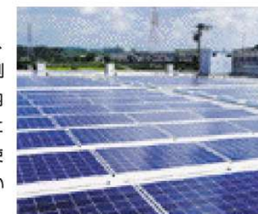
本社工場・屋上太陽光発電システム
